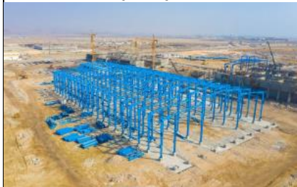
واحد 200 هزار متر مکعبی آب آسیا
